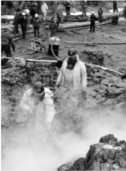
Рис. 3. Ликвидация последствий разлива нефти в районе побережья
